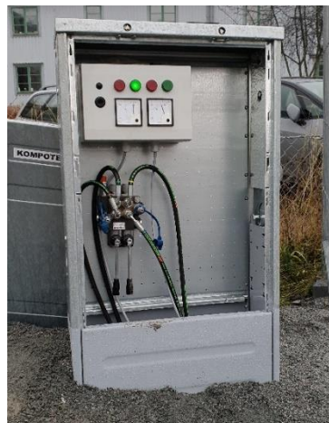
Lokaldrift med batteridrivet indikerings-skåp
